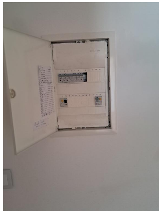
Der Sicherungskasten ist auch dort
